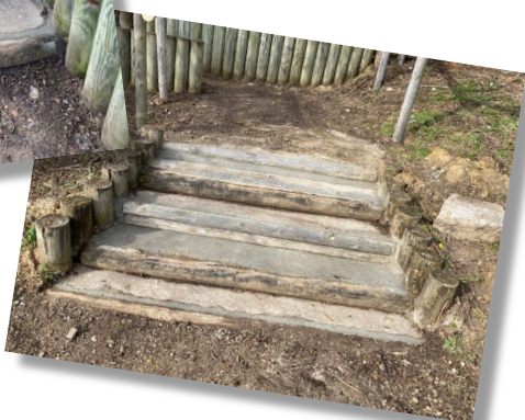
Réfection des marches de la Chaussée Brunehaut suite à des dégradations dues aux passages de motocross, chevaux...
